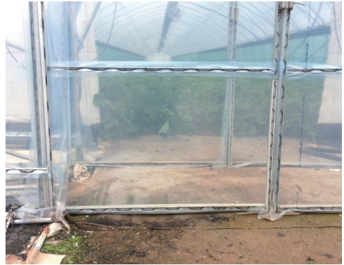
[그림 14] 출입문 하단부와 지면의 틈새 이격 하부 틈새 이격은 작으나 하부 보강재 미설치
