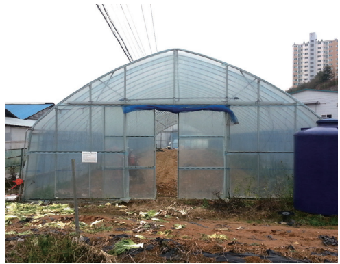
[그림 4] 출입문 하단부와 지면의 틈새 이격 연중 재배를 위한 시설 활용 시 하부틈새 이격 보완이 필요한 시설임
