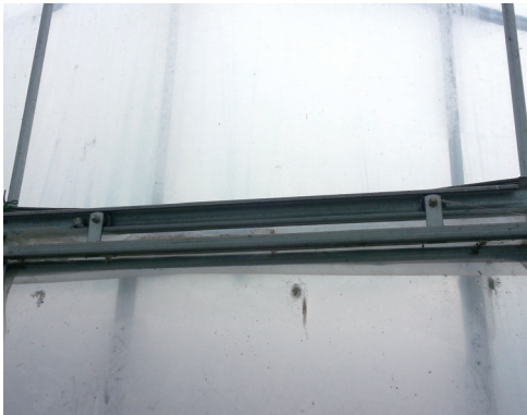
[그림 9] 상부 레일과 문짝 틈 발생 레일은 접촉면이 직선 구조이고 파이프 는 곡선구조로 면 접촉시 공간이 발생함
